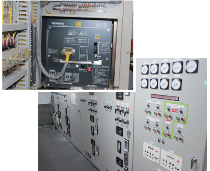
受電設備外観と交換したVHBユニット
